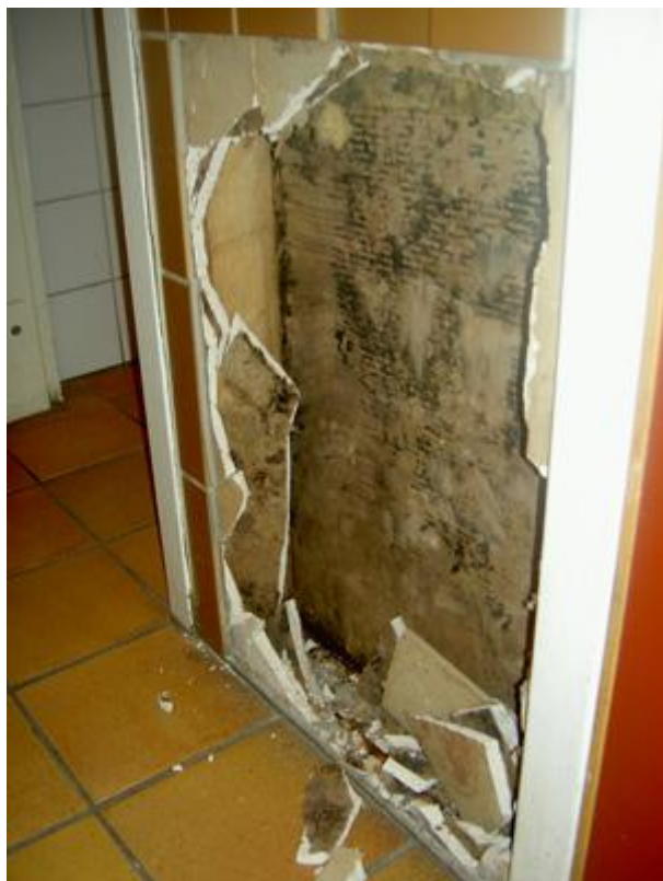
Fig. 1 Mögel kan ofta dölja sig inuti en byggnadskonstruktion. Foto: Aime Must
